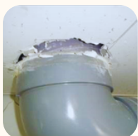
ダクトのずれによる 天井の破損
